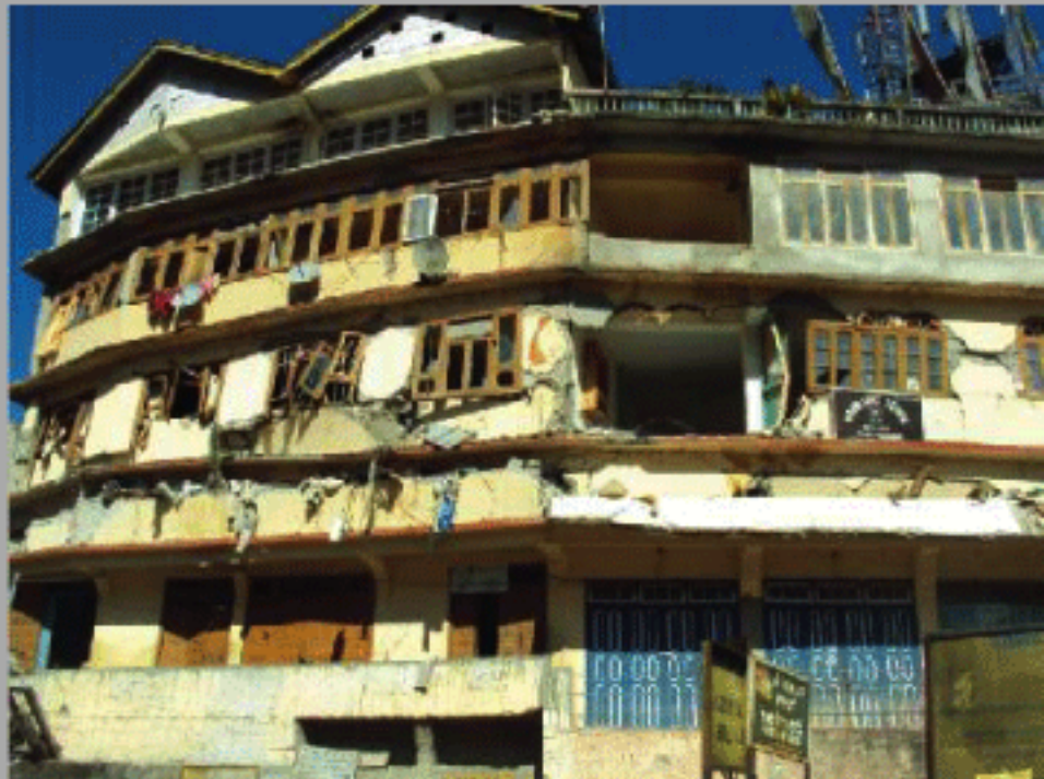
उत्तर जिल्लाको चुङथाङ बजारस्थित क्षतिग्रस्त मूनलाइट अकादमी भवन
